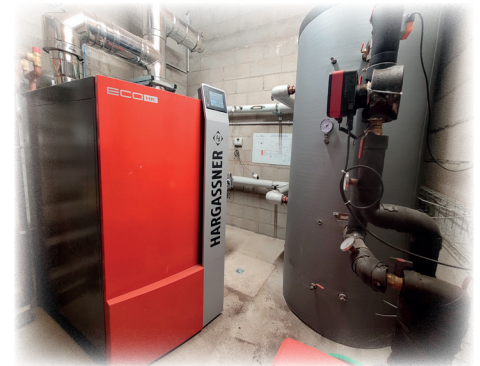
Chaudière et ballon tampon de 887 litres
