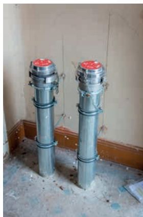
Raccords pour remplissage des silos
