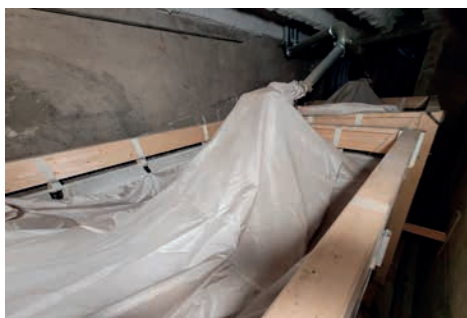
Deux silos en textile et tuyaux de remplissage
