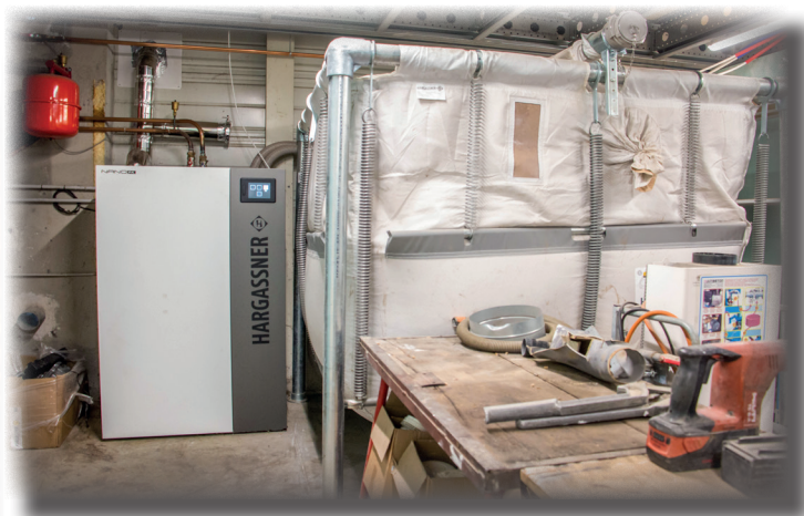
Chaudière Hargassner (Nano PK 20), silo textile et vase d'expansion (en rouge)
