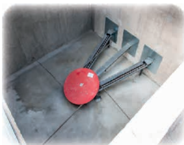
Dessilleur rotatif avec 2 vis d'extraction, une pour chaque chaudière.
