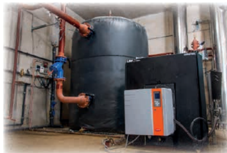
Ballon tampon de 5 000 litres, avec canalisations départ et retour chaufferie, et chaudière d'appoint-secours (à droite).
