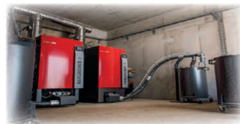
Les deux chaudières Hargassner, de 150 kW chacune et récupérateurs de cendres
