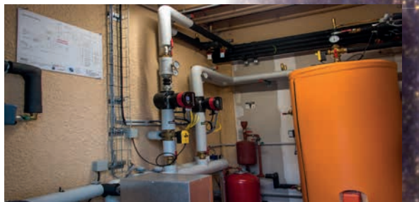
Une des six sous-stations, avec échangeur et départs chauffage et ECS
