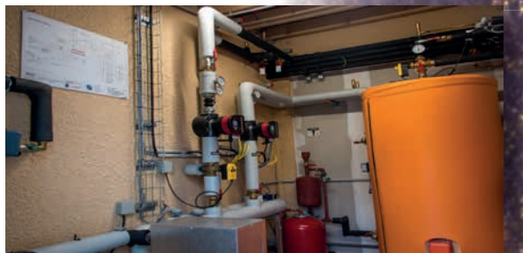
Une des six sous-stations, avec échangeur et départs chauffage et ECS
