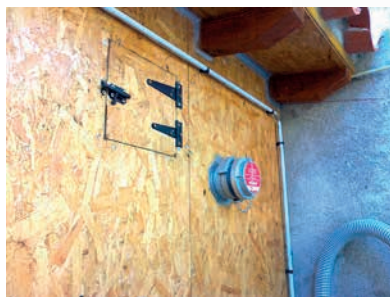
Raccord de remplissage du silo
