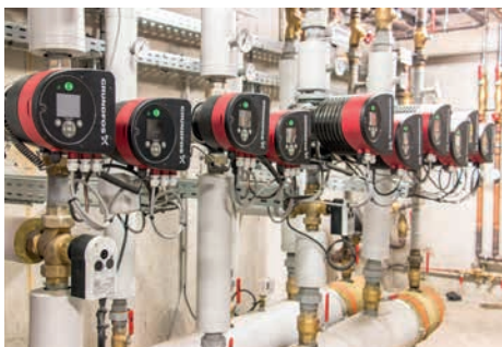
Dans le local chaufferie, panoplie hydraulique
