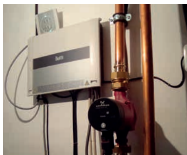
Panoplie hydraulique et régulation
