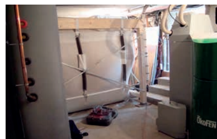
Local chaufferie avec chaudière, ballon d'eau chaude et silo textile (au fond)
