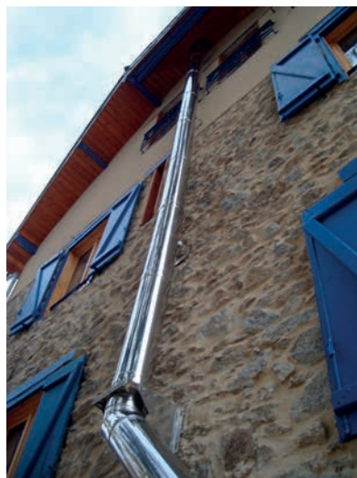
Conduit d'évacuation des fumées
