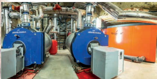
HEIZOMAT, 800 kW, et les deux chaudières fioul d'appoint-secours (bleues)
