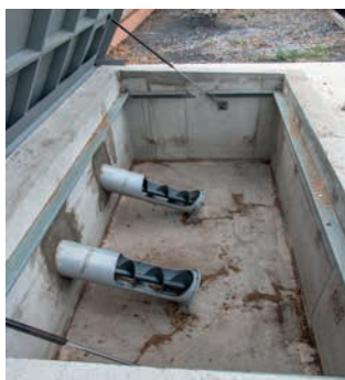
Double-vis sans fin amenant le combustible de la trémie au silo.
