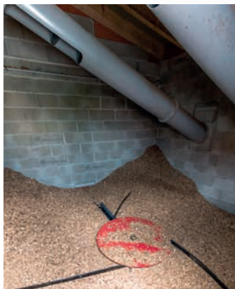
Intérieur du silo : extracteur rotatif en bas et vis de remplissage en haut.
