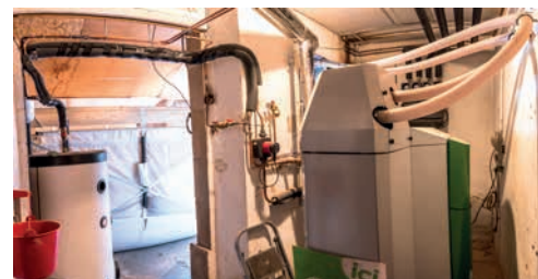
Local chaufferie avec chaudière, ballon d'eau chaude et silo textile (au fond)
