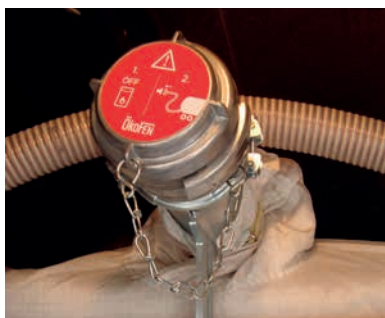
Raccord de remplissage du silo
