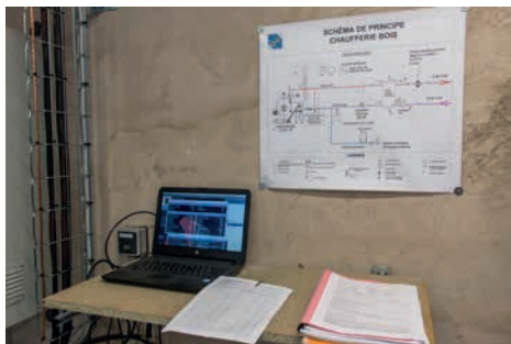
Dans le local chaufferie, le schéma de principe de la chaufferie bois et l'ordinateur permettant la Gestion Technique Centralisée (GTC)
