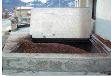
Silo enterré et son système d'ouverture
