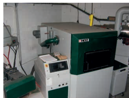
Chaudière HERZ 250 kW
