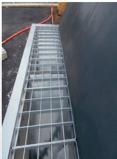
Trémie de remplissage du silo
