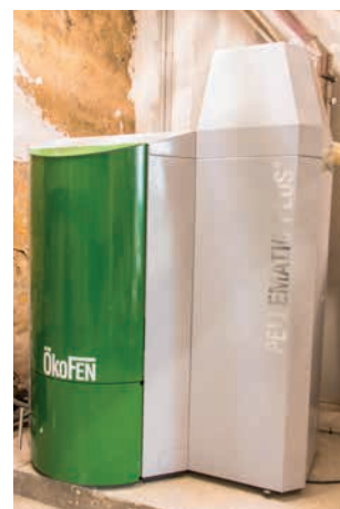
Chaudière ÖkoFEN, 32 kW
