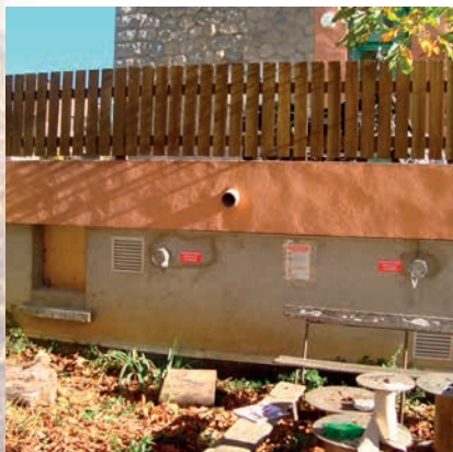
Silo semi-enterré, 17 m 3 Remplissage par camion souffleur via un raccord pompier (bouche)
