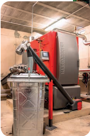
Chaufferie, MAS de la «Desix», Sournia
